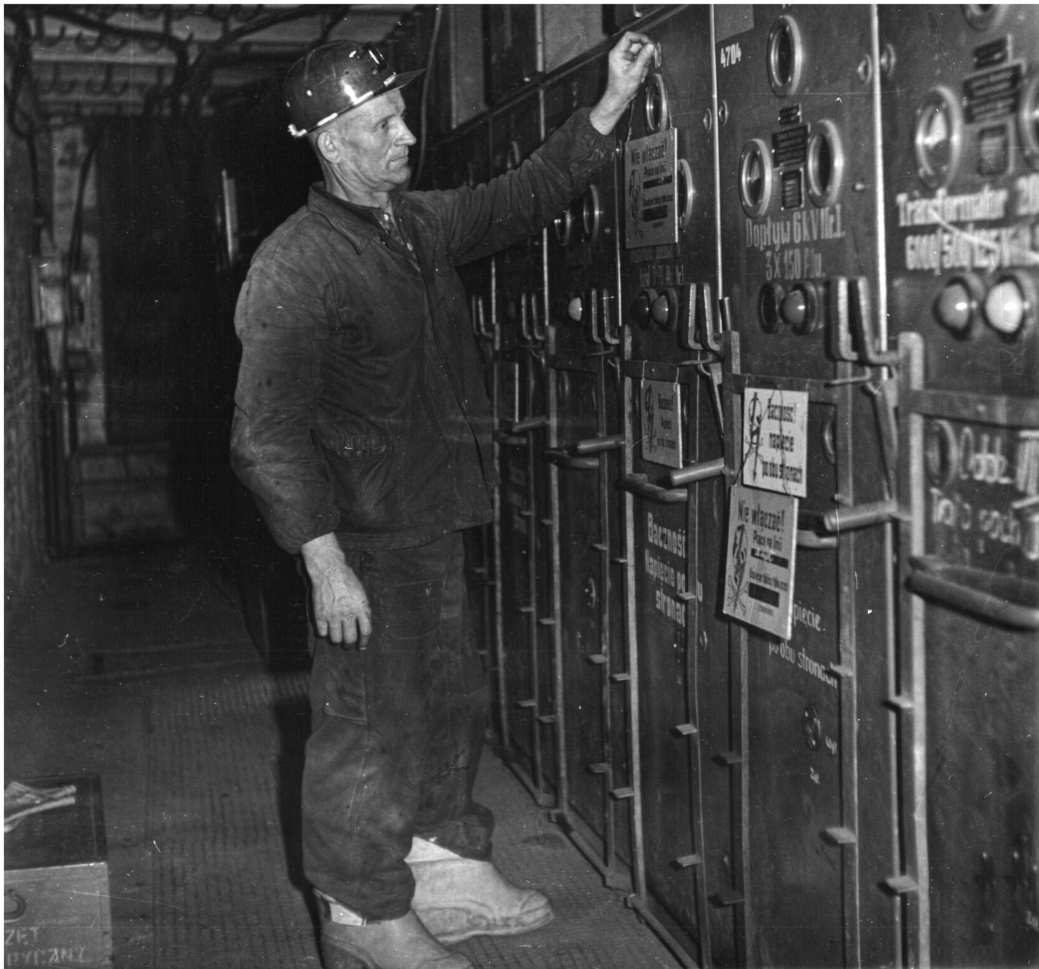
Rozdzielnia przy głównym odwadnianiu poz.150
