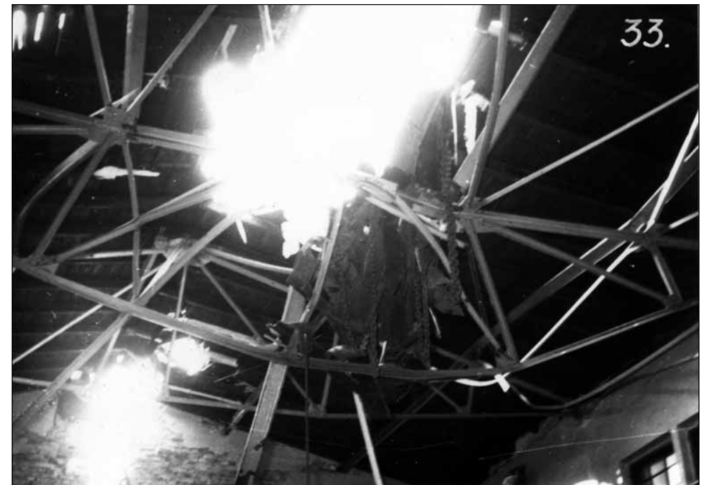
Fot. 5. Wybita dziura w dachu budynku maszyny wyciągowej. Na konstrukcji dachu wsparta suwnica zrzucona z wieży szybowej. Fot. ze zbiorów Archiwum Państwowego w Katowicach
