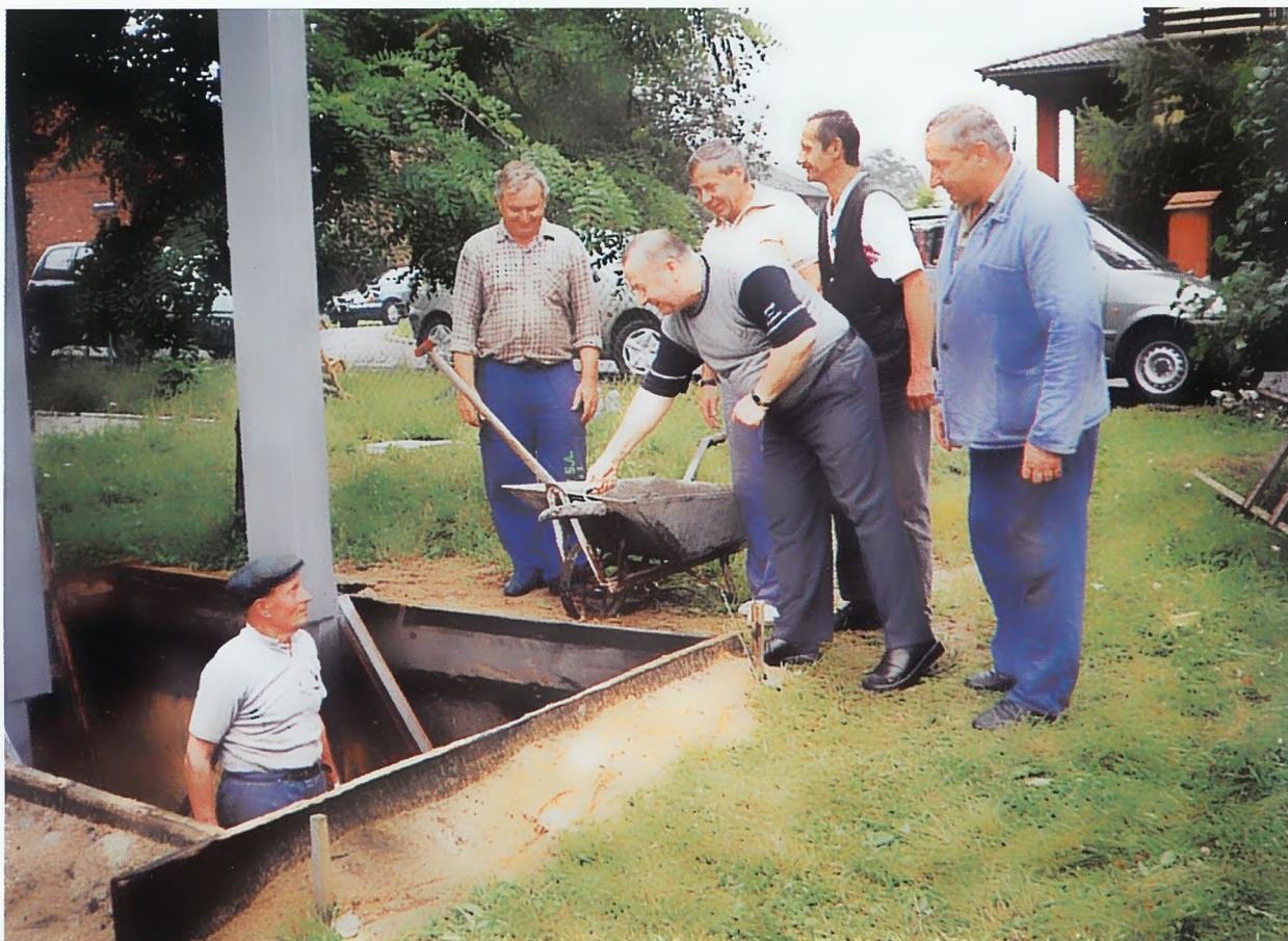
Prace budowlane - betonowanie fundamentów konstrukcji pod dzwon św. Barbary. Zaprawę podaje ks. Józef Przybyła. Pierwszy z prawej Zygfryd Ścierański.(17.07.2001r.) fot. Antoni Piszczek.
